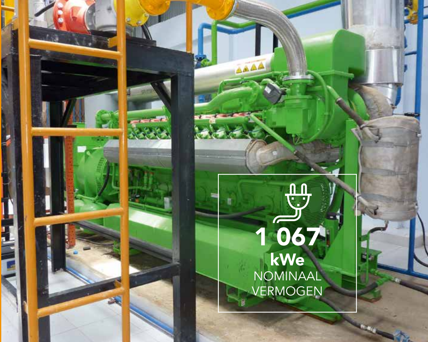
Close-up van de gasmotor
