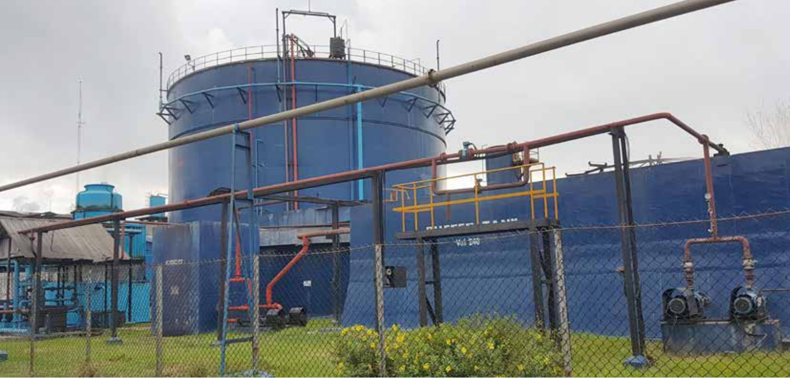
Anaerobe reactorvat (midden), en een deel van de installatie voor de opvang van methaan
