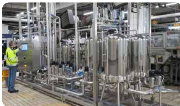
Cold Stabilisation Module (CSM) op de brouwerij site van Molson Coors - Zagreb
