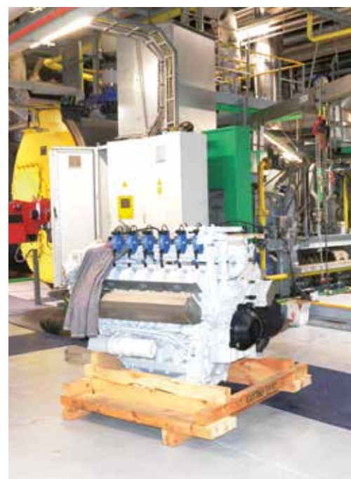
Warmtekrachtkoppelingssysteem in de hoofdzetel van D'Ieteren.
