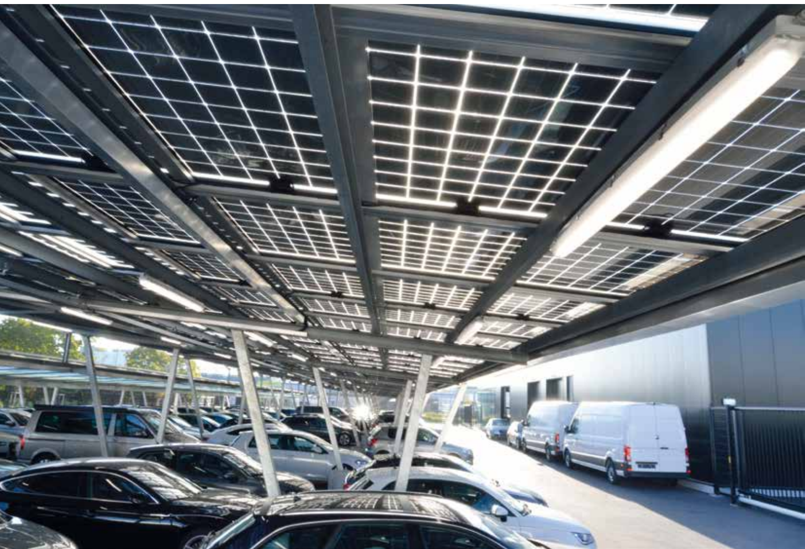
Er werden fotovoltaïsche carports geïnstalleerd in het nieuwe carrosseriegebouw van Wondercar in Drogenbos. Er wordt 301 MWh elektriciteit per jaar geproduceerd, goed om 50 tot 100 VW e-Golfs of bijna 150 Audi Q7 e-trons per dag te herladen.
