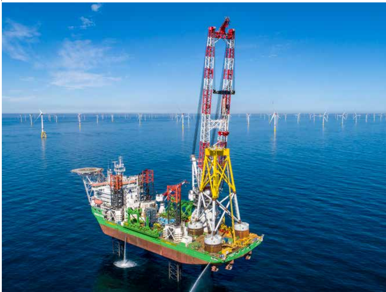
Het offshore windpark Borkum Riffgrund 2 - Duitsland
