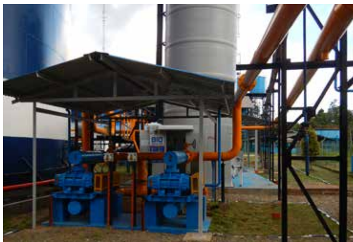
SIPEF - Detail van een anaerobic reactor en gas cleaner bij Agro Muko
